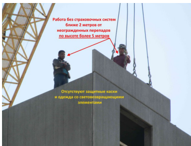
Рис. 3. Отсутствие средств защиты
