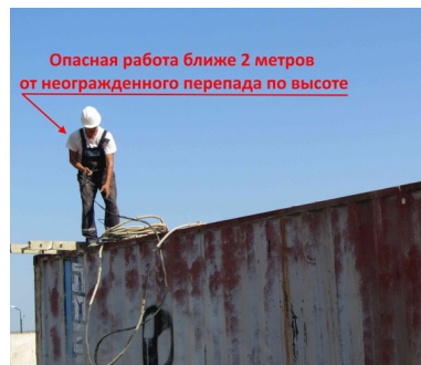
Рис. 4. Неограждённый перепад по высоте
