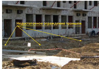
Рис. 6. Недостаточное ограждение траншеи
