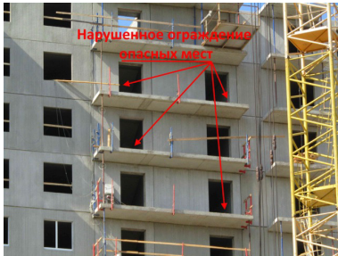
Рис. 5. Отсутствие ограждения опасных мест
